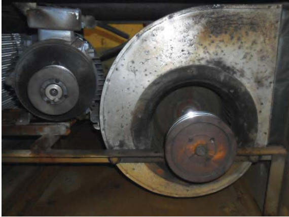
Rikkoutunut, energiasyöppö hihnavetoinen kammiopuhallin.
